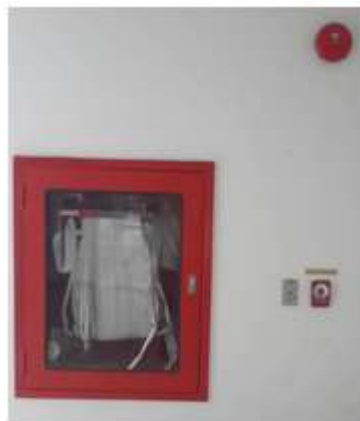
ภาพ 6.4 อุปกรณ์ดับเพลิงและสัญญาณเตือนไฟไหม้
